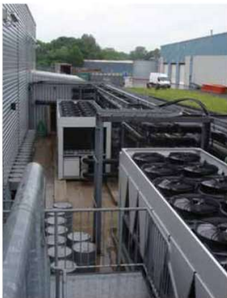
Enfriadores DeltaChill™ FreeCool suministrando refrigeración libre a unidades interiores en un centro de datos de Manchester
